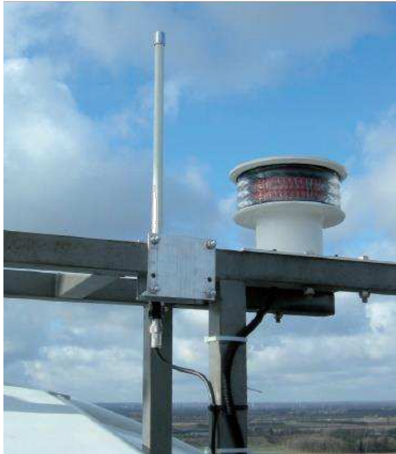
Transponderantenne Quelle: Enercon
