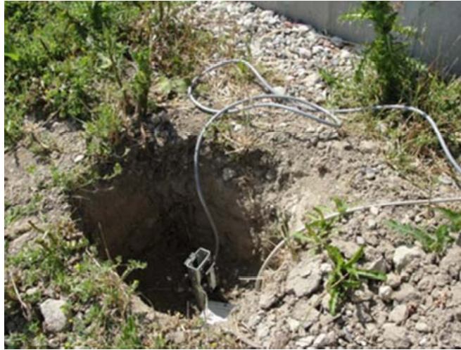
Schwingungssensoren im Erdreich
