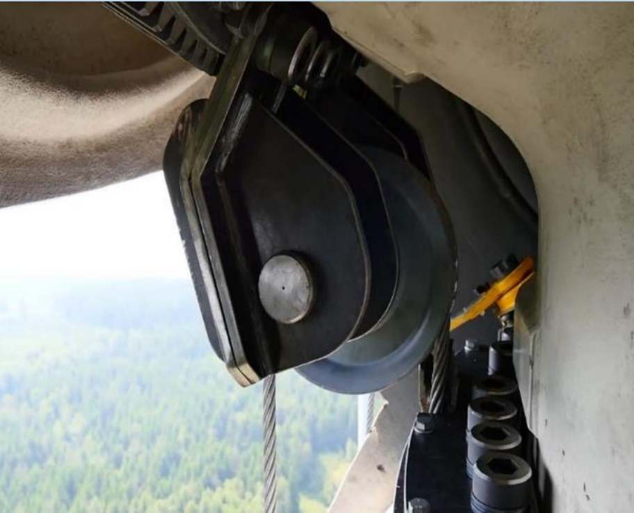
Seilumlenkung und Anschlagpunkt: Anlagenspezifisch konstruiert und ausgelegt
