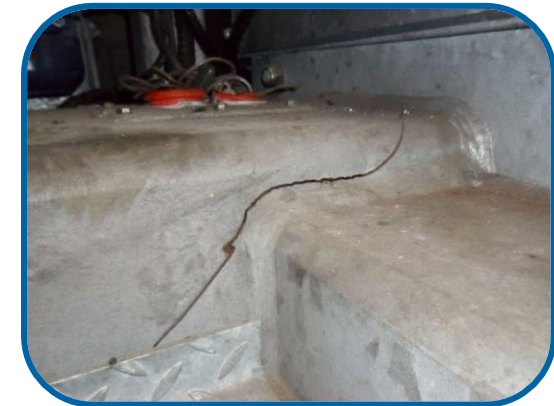
Risse in Maschinenträgern
