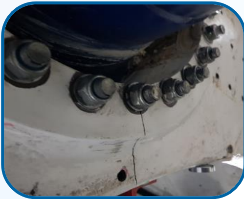
Risse in der Nabe
