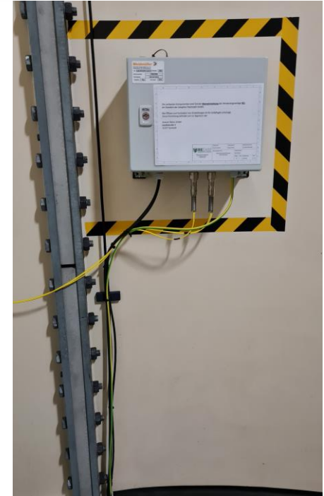
Schaltkasten zur Weiterleitung der Alarmmeldungen (Quelle: Hunwardsen)
