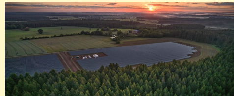
PV-BESS Pfaffenweiler, DE
