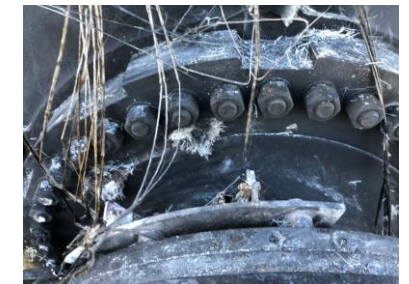
Folgeschaden durch blockiertes Hauptlager
